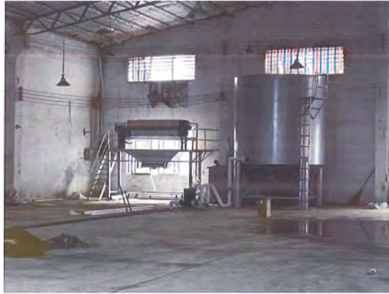
20t/h 一体化净水工程
