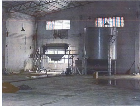
20t/h 一体化净水工程
