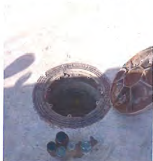
生活污水排放口
