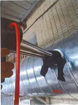
烧结、定型工序废气处理前
