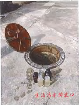
生活污水排放口
