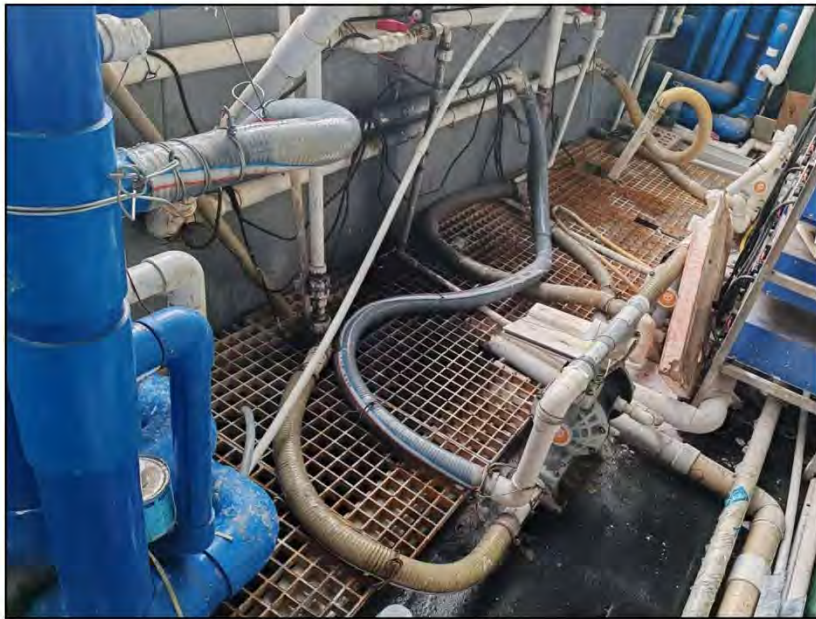
图 4.1-3 废水收集池照片
