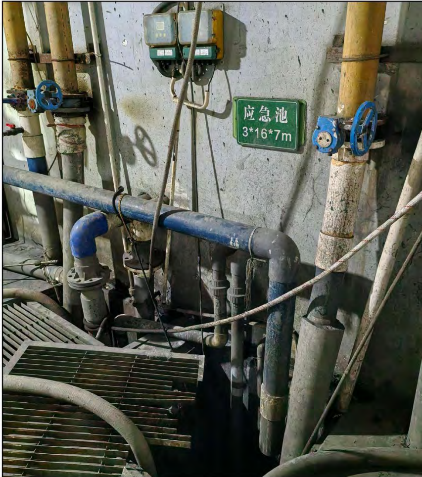
图 4.2-2 依托的元子环保共性产业园内事故应急池
