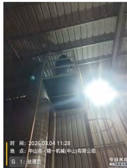
去油污工序、调漆、喷枪清洗、喷漆及其后晾干工 序废气排放口 G1 (处理后) (2026.03.04)
